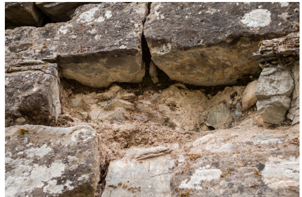
Figura 15. Cortina norte. Agujero por falta de sillar.
